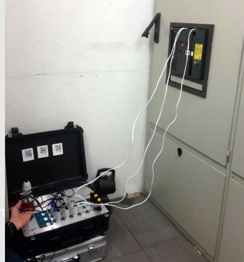
Mobile (temporäre) Messtechnik
